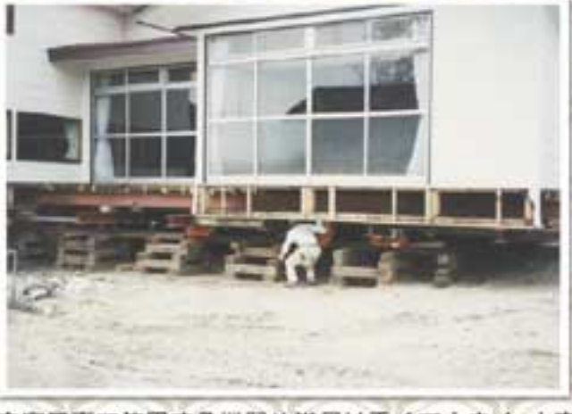
曳家工事で使用する機器や道具は重くて大きく、大変な重労働。工事の様子は一瞬の目に触れにくいですが、技術の専門性は高く、社会に果たす役割も大きい。
