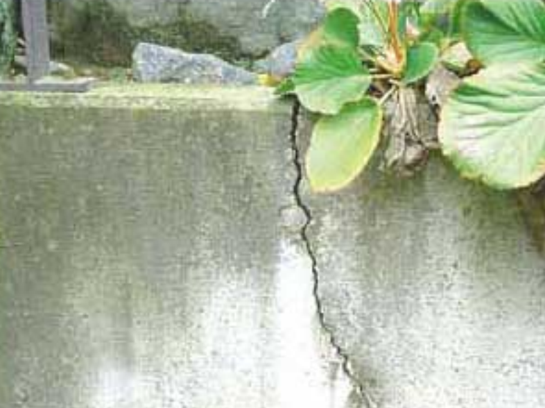
地盤の沈下で、建物の基礎部分に亀裂が生じる
