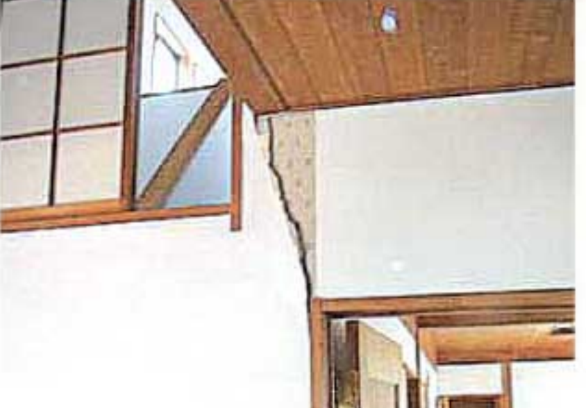
建物にゆがみ、内・外壁に亀裂が生じる
