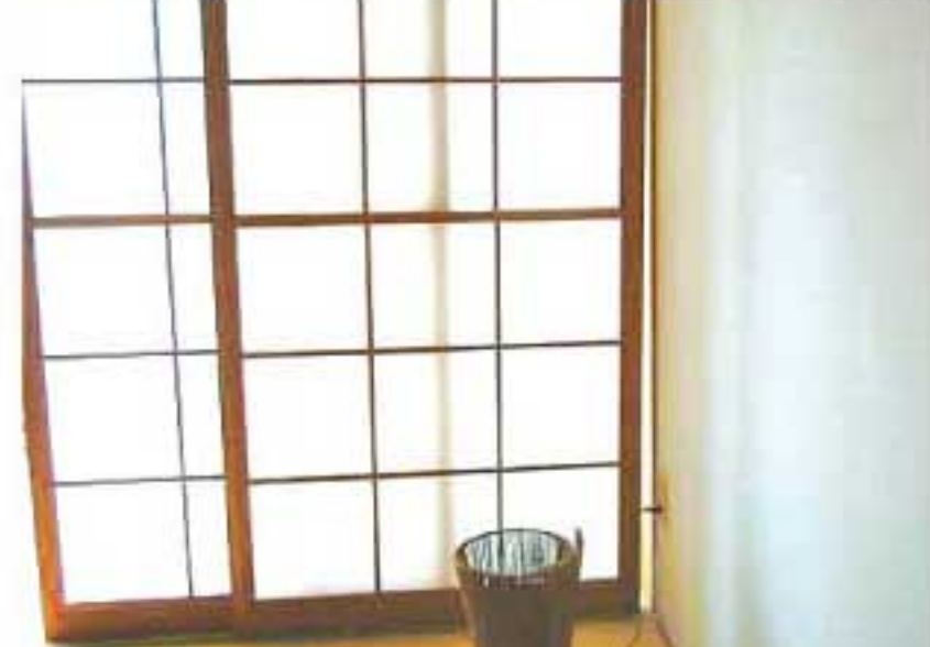
扉や窓の枠がゆがみ、開閉しづらく、隙間ができる
